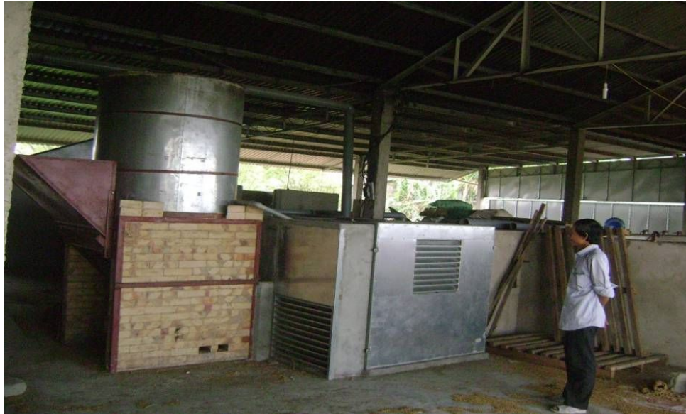
Hình 5. Máy sấy đảo chiều gió SRA-10 lắp đặt tại nhà máy chế biến xay xát lúa gạo của Hợp tác xã nông nghiệp Thủy Thanh 2, tỉnh Thừa Thiên Huế, tháng 10-2012
